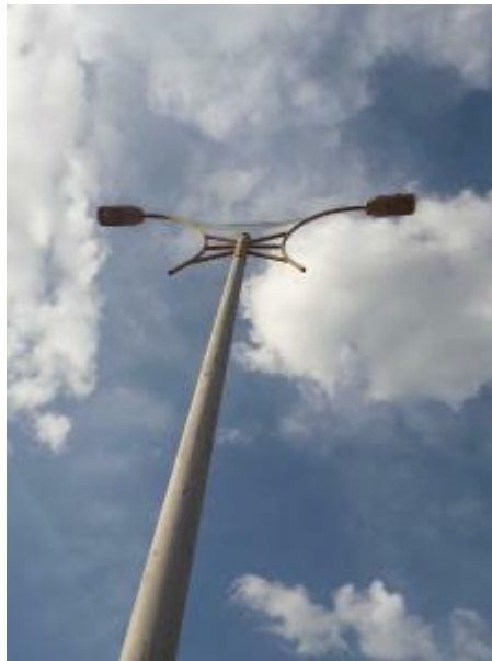
Imagem 3 – Poste da Rua João da Mata e Silva (parte 1)
