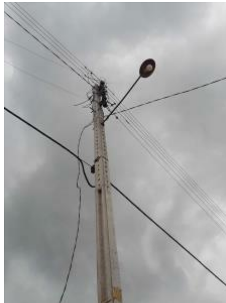
Imagem 5 – Poste das Vias Locais
